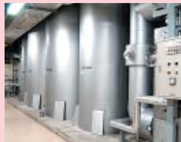
ガスエンジン式コージェネレーションシステム
