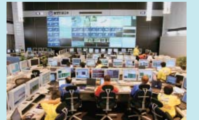
NTT東日本ネットワークオペレーションセンターでは、通信網のトラフィックを24時間リアルタイムで一元的に監視・管理しており、通信設備や伝送路が被災した場合の状況確認などが可能
